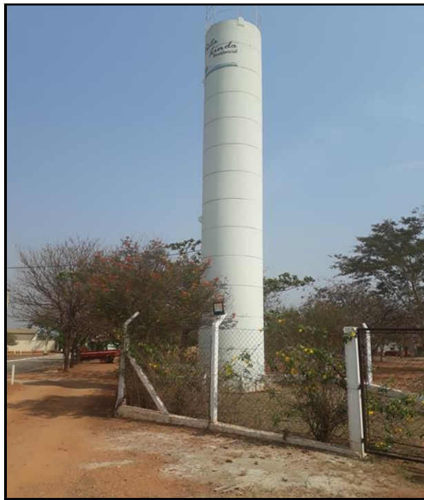
Foto 6- Reservatório no poço P12.
