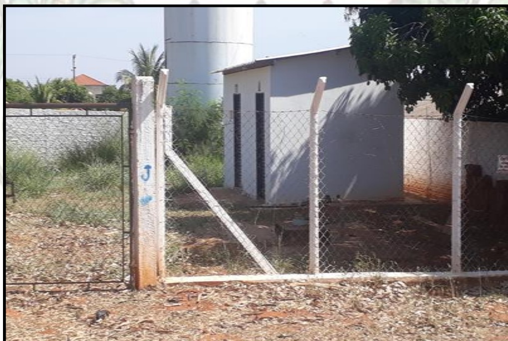
Foto 3- Local das bombas dosadoras.
