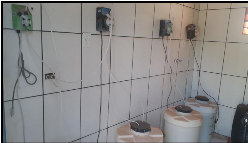
Foto1&2- Bombas dosadoras no poço P05 e P06
