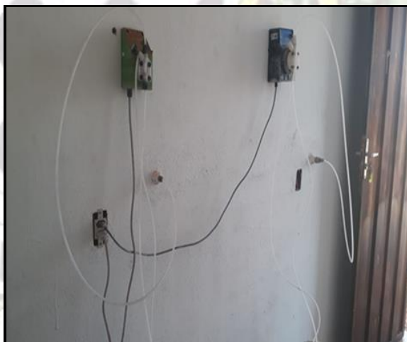
Foto 2- Sistemas das bomba.
