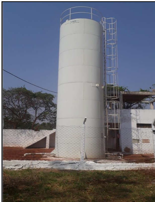
Foto 3- Reservatório do poço P08, na Hípica.
