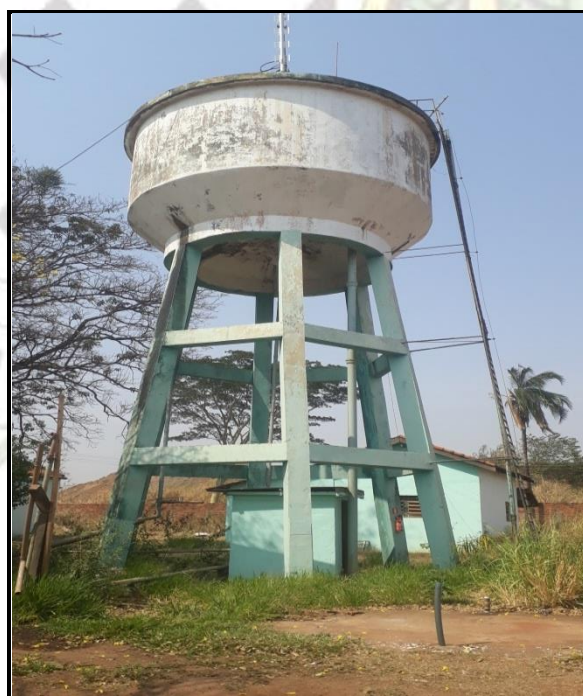
Foto 4- Reservatório do poço P01 & P02.
